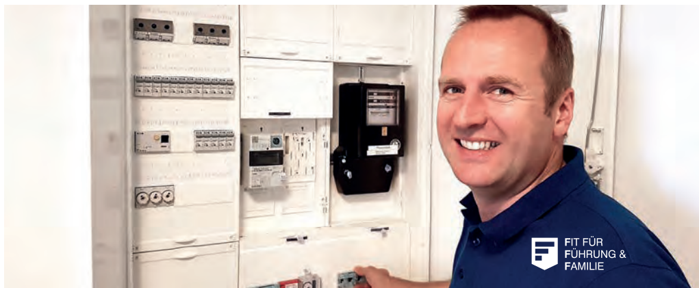
© Bild Georg Dahlhaus, Elektro Zimmer
